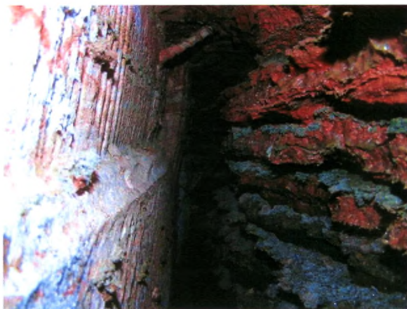
Рисунок 1 – Растворение сильвинитовых пород (справа) в боковой стенке разведочной выработки № 12 по контакту с временной гидроизоляционной перемычкой (слева)
